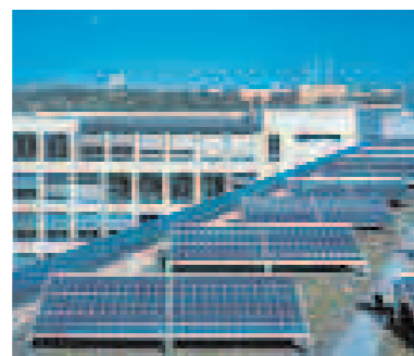
Installation PV-Light sur toit en terrasse avec un rendement total de 20 kWp.
