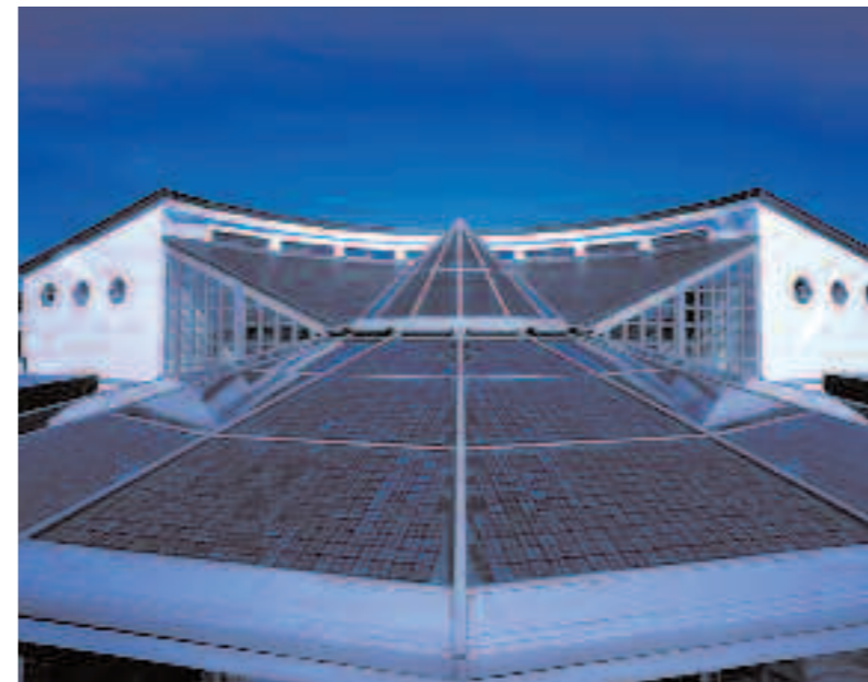
Installation solaire intégrée à une verrière en Aluminium - vue extérieure, 60 modules de 20 dimensions différentes avec un rendement total de 11 kWp.
