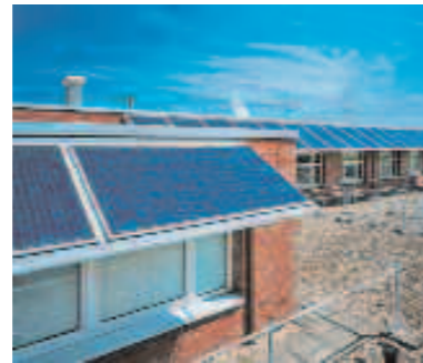
Installation Premium fixée en auvent avec un rendement total de 7 kWp.
