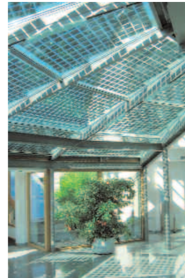
Installation solaire intégrée à une verrière en Aluminium.
