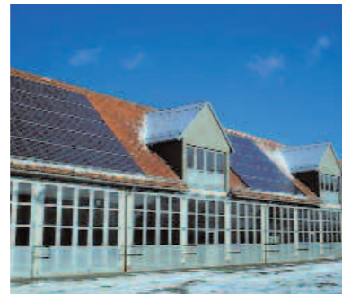
Installation PV-Light montée sur le toit avec 120 modules secours.
