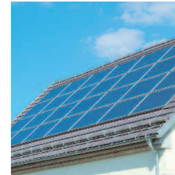
Installation Premium intégrée au toit avec 28 modules et un rendement total de 9 kWp.
